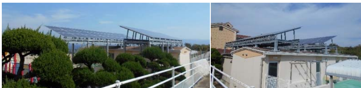
市有施設に導入した太陽光発電設備(伊吹小学校・中学校)
