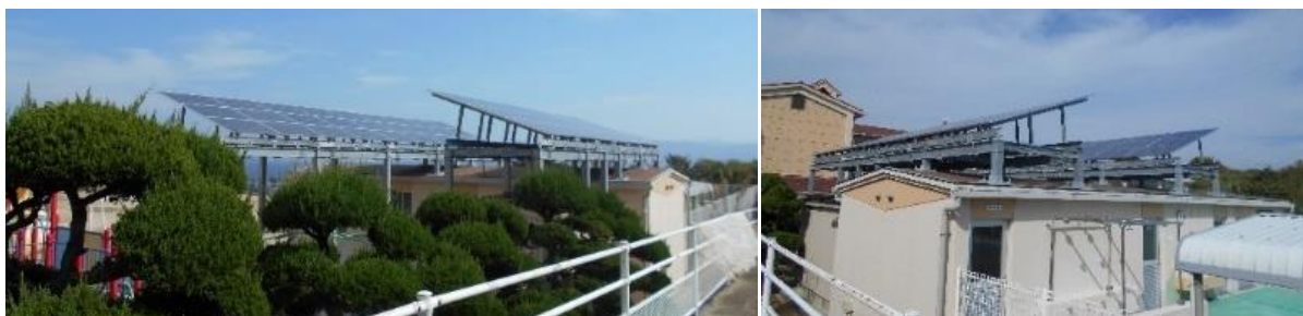
市有施設に導入した太陽光発電設備(伊吹小学校・中学校)
