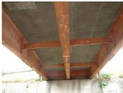
図 1.3 鋼橋の損傷状況（塗装劣化）
