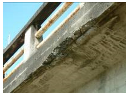
図 1.4 コンクリート橋の損傷状況（鉄筋露出）
