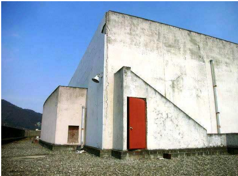
大ホール屋上西側扉付近、外壁剥離が生じ、南側壁にもクラックが生じている様子
