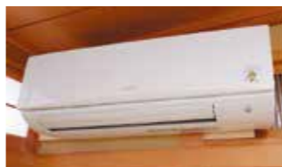
大畑自治会館の5カ所にエアコンを設置
