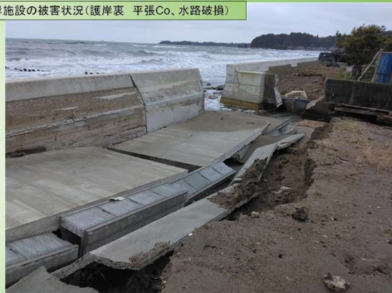
海岸施設の被害状況(護岸裏 平張Co、水路破損)
