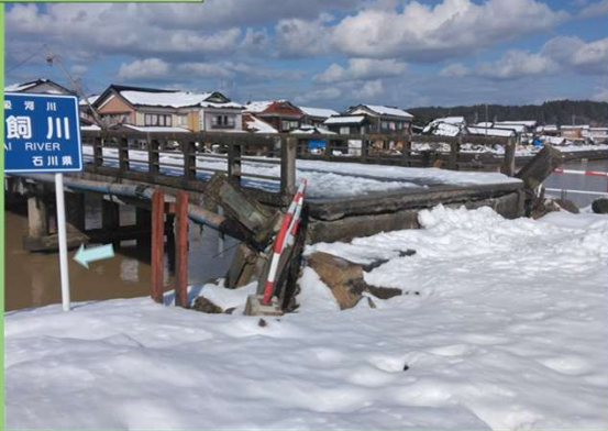
鵜飼川 被災状況(橋梁の段差)
