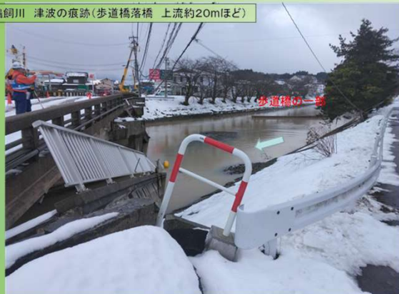
鵜飼川 津波の痕跡(歩道橋落橋 上流約20mほど)
