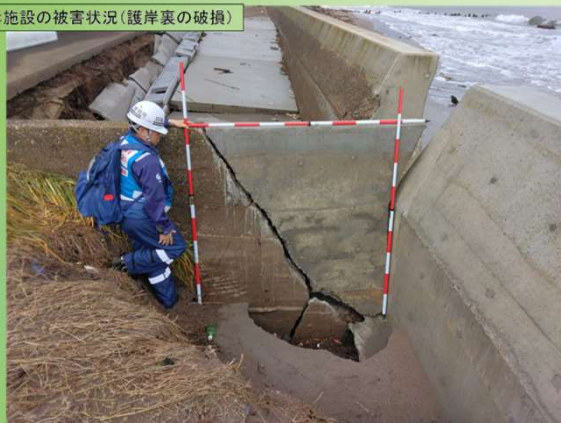
海岸施設の被害状況(護岸裏の破損)
