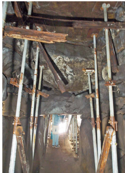
写真5-67 支保工の劣化状況
