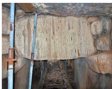
写真5-70 傾いた支保工
