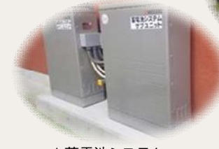
▲蓄電池システム
